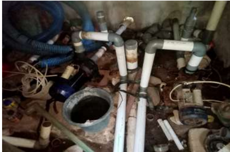
Gambar 5. Pompa dan Instalasi Pipa
