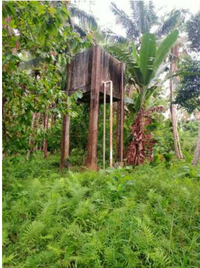
Gambar 3. Bak penampungan air
