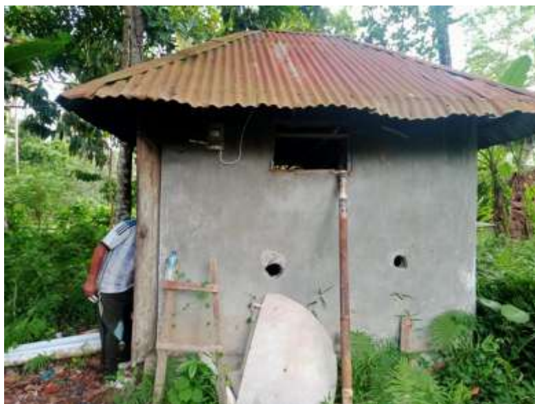
Gambar 4. Rumah pompa dan Instalasi Pipa
