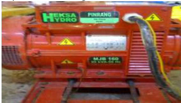
Gambar 13. Generator PLTMH Rampusa.
